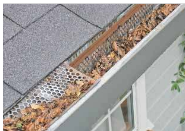
Niewyczyszczone rynny nie spełnią swojej podstawowej roli – odprowadzania wody z dachu
