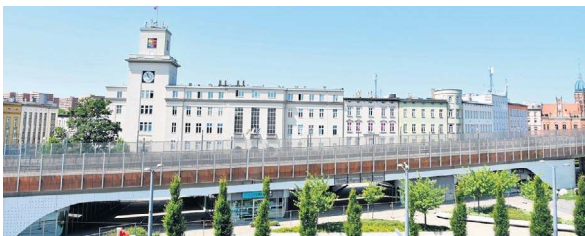
Estakada została zamknięta w czerwcu 2025 roku. Wkrótce znów będzie przejezdna, ale jej stan jest fatalny
