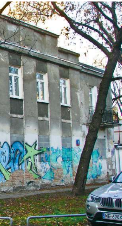
Kamieniczka Bandurskich i ślady ostrzału na elewacji zachodniej budynku
