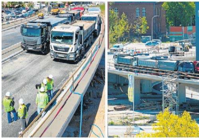
To jeden z kluczowych momentów inwestycji. Ciężkie TIR-y dokonały próbnego obciążenia nowego obiektu.
