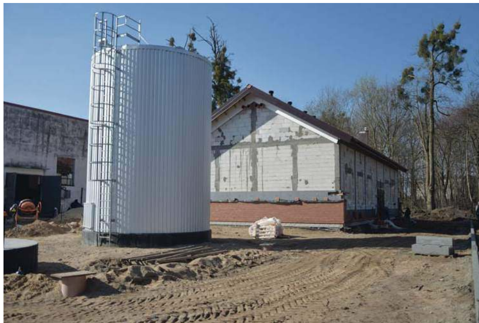
Budynek nowej stacji uzdatniania wody w Prejłowie, widok na zewnątrz i w środku
