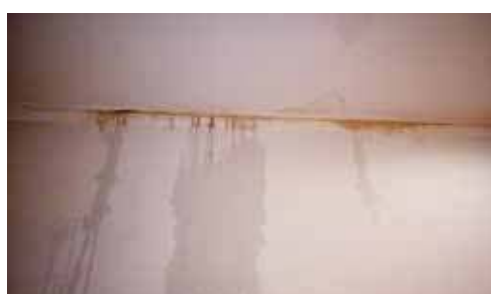
Dyrektor Janusz Kuklewicz skarżył się radnym na pogłębiający się problem z nieszczelnym dachem
