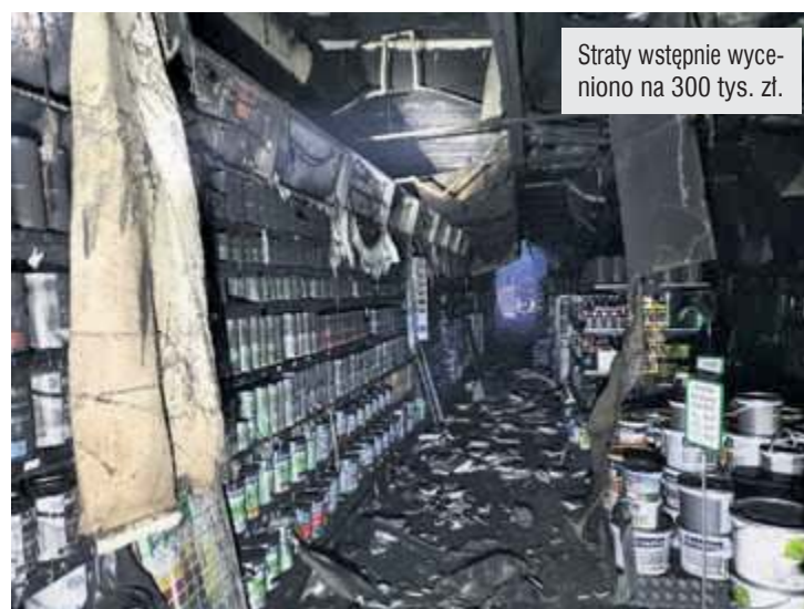
Po zakończonej akcji gaśniczej pracownicy przystąpili do porządkowania hali.
