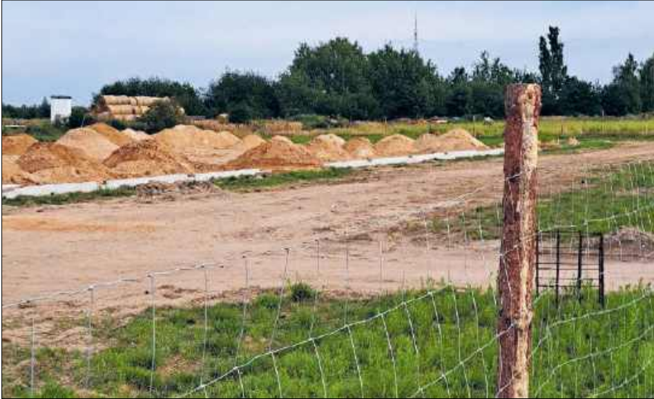
Pozwolenie na budowę PSZOK-u zostało wydane z dniem 17 kwietnia 2025 r., prace zostały rozpoczęte w tym roku, a ich zakończenie planowane jest w roku 2026
