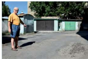
Nawierzchnia podwórka pozostawia wiele do życzenia
