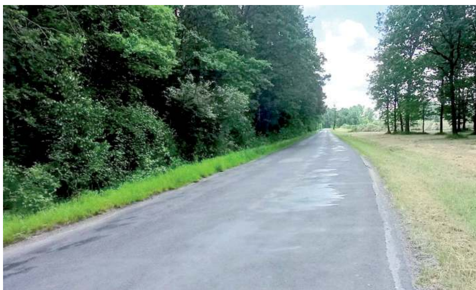
Droga jest w bardzo kiepskim stanie. W przebudowie chodzi o liczący około kilometra długości odcinek, mniej więcej od stawów hodowlanych do granicy Białki
