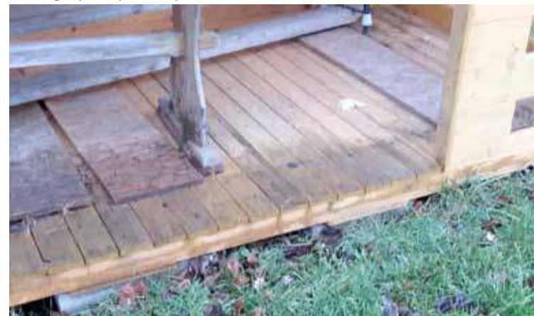
Wilgoć już wżera się w podłogę tarasu
