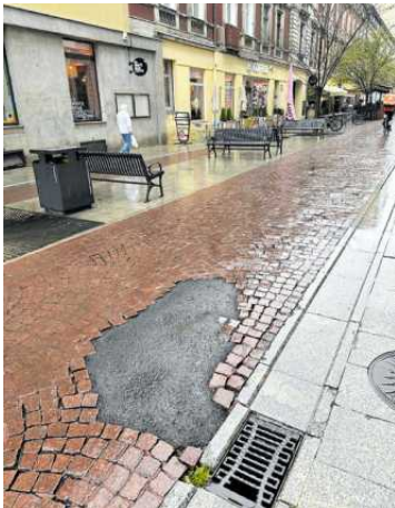
• Łata na woonerfie na ul. Traugutta FOT. BARTŁOMIEJ DERDZIKOWSKI
