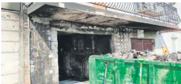
Zniszczone zostało wszystko, co znajdowało się w garażu, ale również elewacja budynku i wszystkie instalacje. Fot. zrzutka.pl
