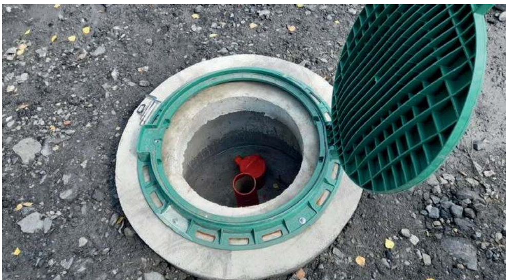
Piezometr umożliwia monitorowanie i kontrolę zatapiania górotworu. Fot SRK
