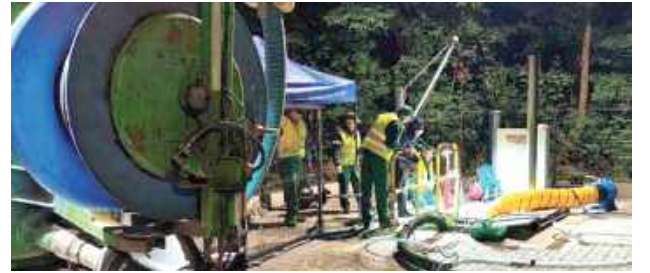
Podczas czyszczenia z wnętrza przepompowni usunięto nagromadzone zanieczyszczenia stałe, przede wszystkim zbite włókny, takie jak szmaty czy chusteczki nawilżane. Tego typu odpady nie powinny trafiać do kanalizacji, ponieważ utrudniają pracę urządzeń i mogą prowadzić do kosztownych awarii
