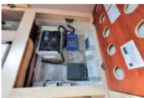
Przestrzeń sekcji elektrycznej, wodnej i ogrzewania pod siedzeniami salonu
