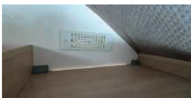
Wywietrzniki znajdują się na bocznych ścianach, nad półką podsufitową z przodu przyczepy
