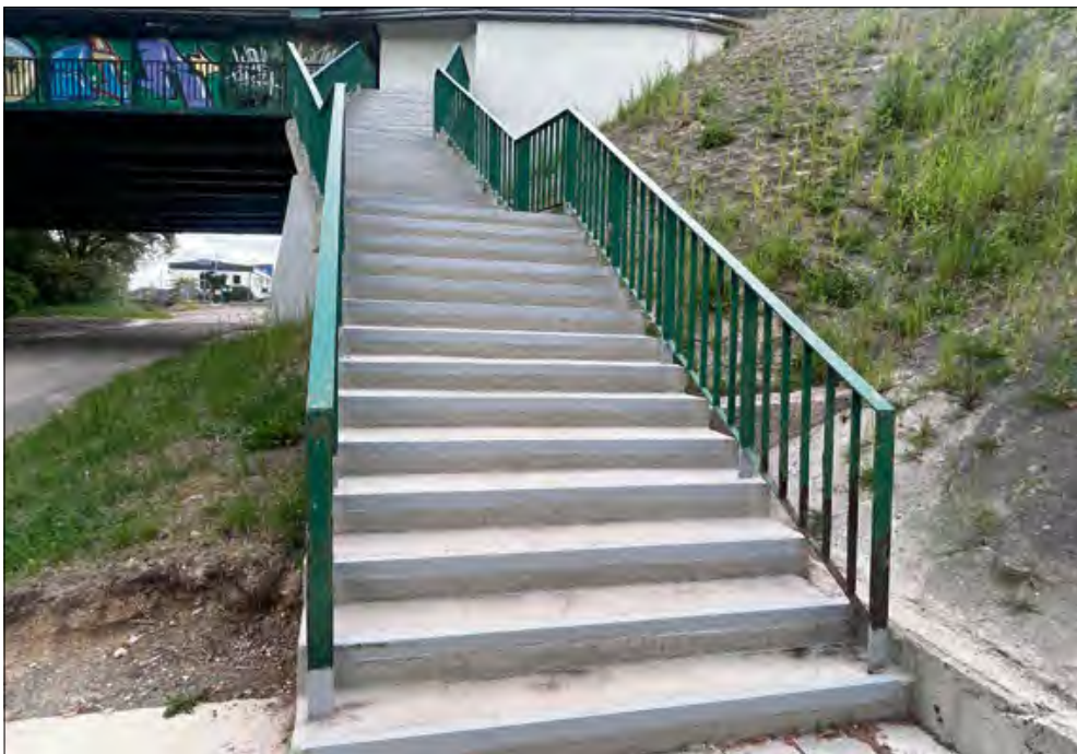
Schody po opadach deszczu są bardzo śliskie.
