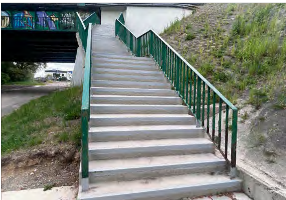
Schody po opadach deszczu są bardzo śliskie.
