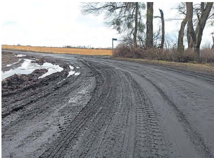
Mieszkańcy nie proszą o asfalt, a „jedynie” o porządne utwardzenie.
