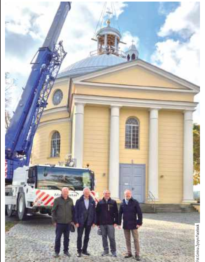
Dach kościoła pw. św. Apostołów Piotra i Pawła wygląda zupełnie inaczej. Na jej górze zamontowano nową, połączoną latarnię z odnowionym krzyżem
