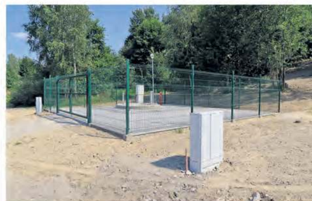
Tłocznia ścieków S7 w miejscowości Charzykowy
