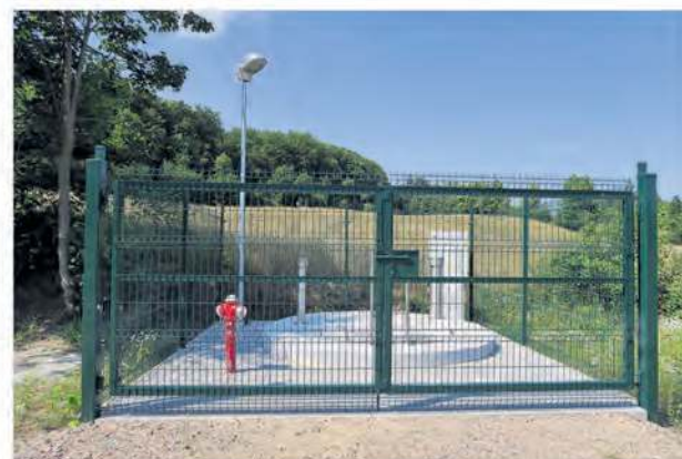
Tłocznia ścieków S11 w miejscowości Charzykowy
