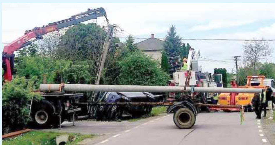
Słup energetyczny w Ruszowie trzeba było błyskawicznie wymienić
