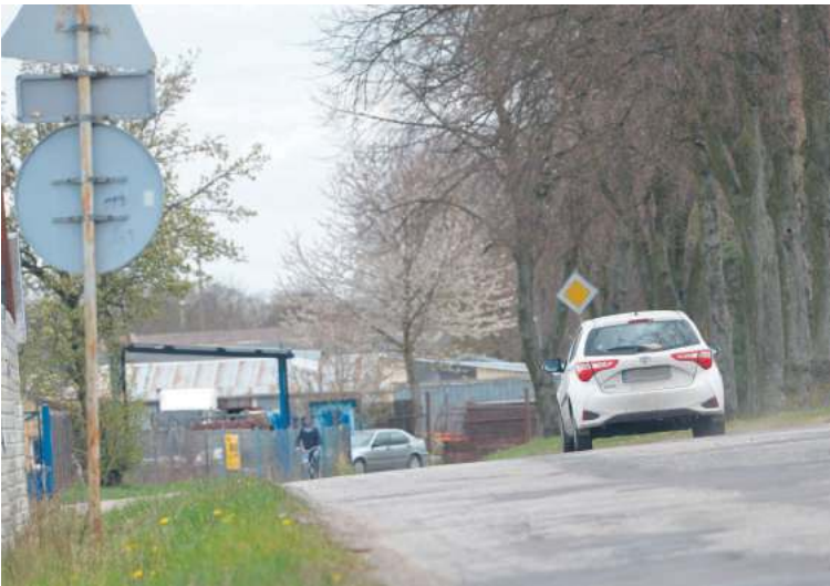
- Ulica Dworcową to najkrótsze i najszybsze połączenie rowerowe Świdnika z Lublinem. Jest to najbardziej wyczekiwana inwestycja drogowa przez rowerzystów, osoby pracujące i uczące się w Lublinie, a mieszkające w Świdniku. Najbardziej zniszczony fragment drogi znajduje się w sąsiedztwie ulicy Brzegowej, ale ten powiat planuje przebudować dopiero w ramach II etapu inwestycji.
