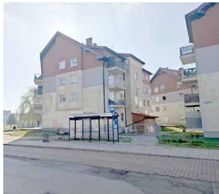
Budynek przy ul. Armii Krajowej na os. Pyrzyckim popękał prawie 3 lata temu
