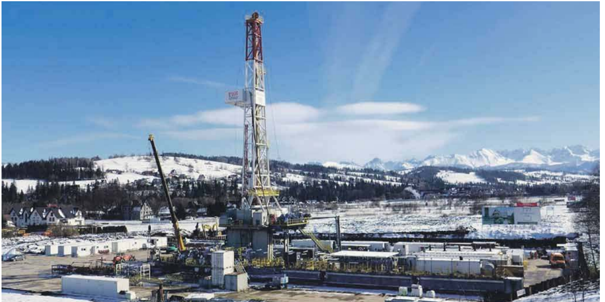
Odwiert geotermalny w Szaflarach
