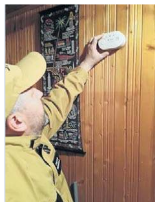
Czujki u wytypowanych rodzin instalowali druhowie
