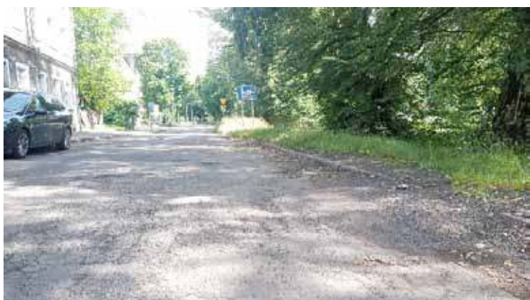
Niestety w tym miejscu, mimo widocznych lat, nadal jest pełno wybo
