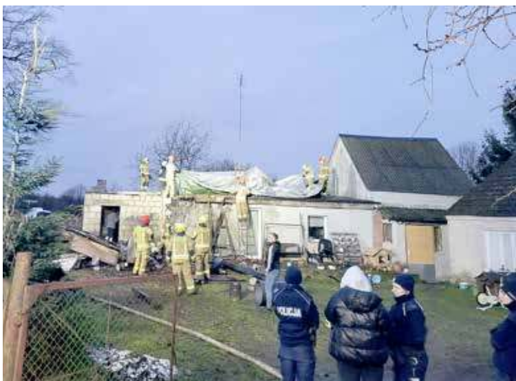
Zabezpieczenie części objętej pożarem Foto. OSP Osowo
