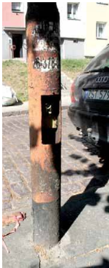
Otwarta pokrywa złącza skorodowanego słupa na ul. Płatnerzy
