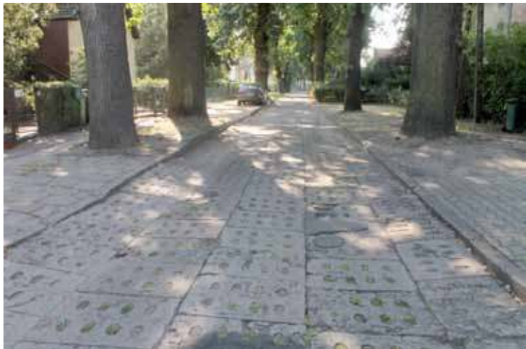
Droga z płyt jumbo ma w niejednym miejscu dziury i nierówności
