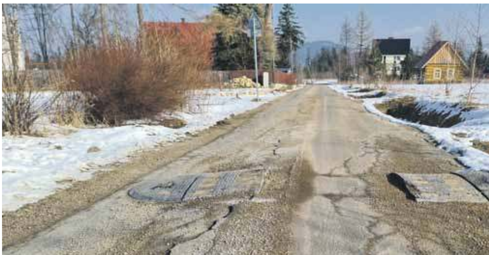
Tak wygląda „wyremontowana” droga na Wyskówkach.
