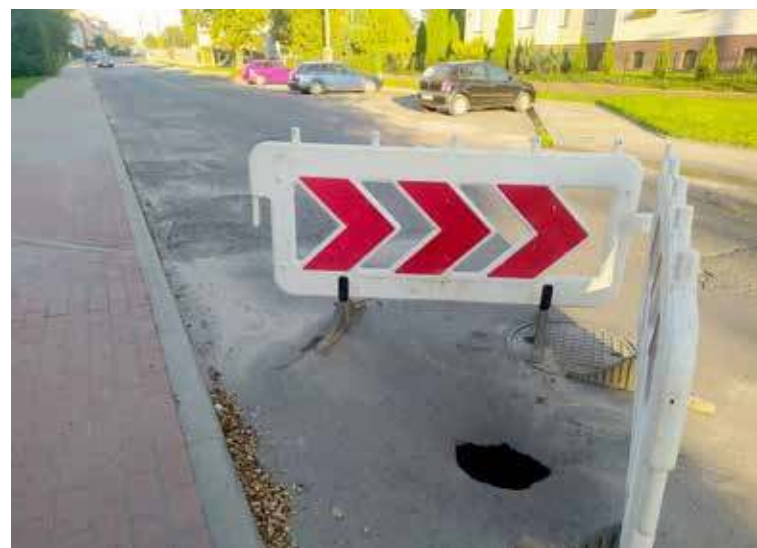
Sporej wielkości dziura została ujawniona przed tygodniem. Na razie została ogrodzona znacznikami
