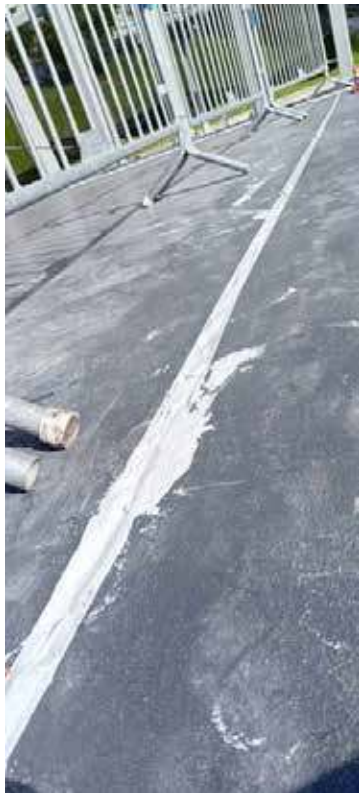
Zniszczone wypełnienie fot. ŁDK
