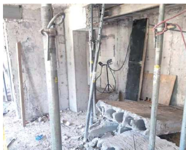
Wstępne czynności wskazują, że 17-latek został przygnieciony przez ścianę w trakcie próby wyburzania - informowali policjanci
