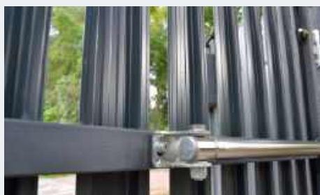
ⓘ Siłowniki teleskopowe przykręcono do ram skrzydeł najpierw zbyt krótkimi śrubami (szybko zostały wyrwane).
