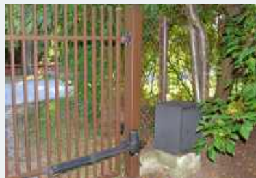
Centralę sterującą umieszczono na betonowym postumencie.
