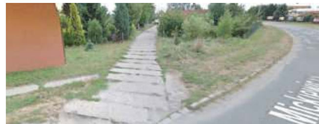
Dojazd do bloku Mickiewicza 59A i chodnik z płyt jest w bardzo złym stanie
