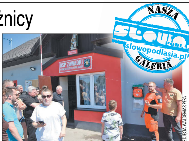
Na ścianie strażnicy OSP Zawadki zamontowano urządzenie AED ratujące życie
