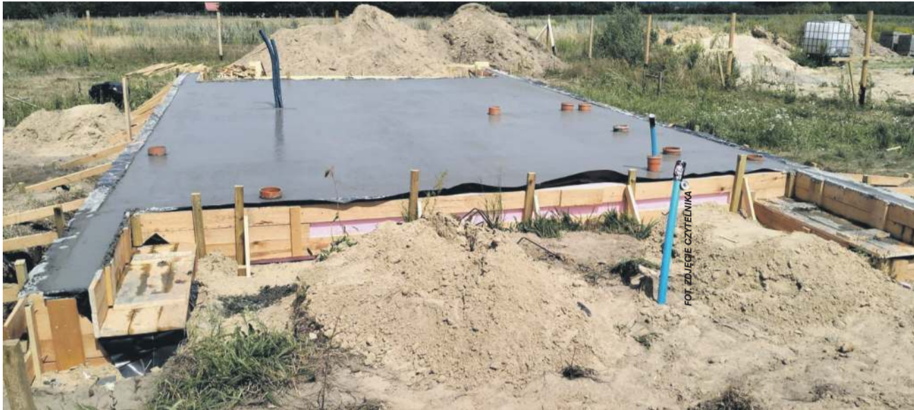
Na tym miejscu miał stać dom dla kobiety i jej syna. Po tym, jak wykonawca zniknął z pieniędzmi, inwestycja utknęła na etapie płyty fundamentowej
