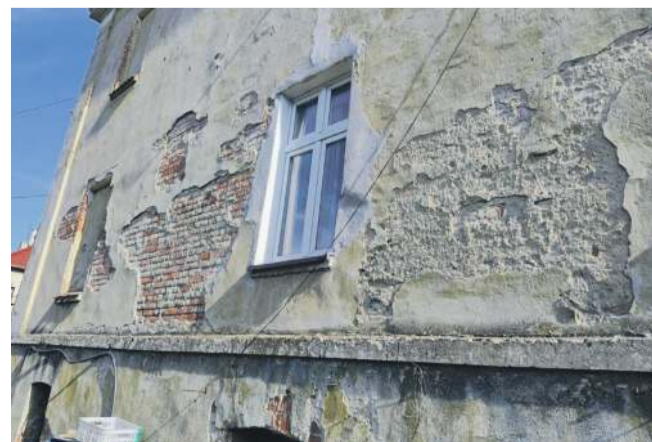
Tynk leci z elewacji
