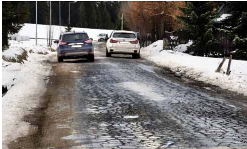
Dziury na drodze wiodącej przez Dzianisz zostały załatane, jednak asfaltowa nawierzchnia jest daleka od doskonałości.
