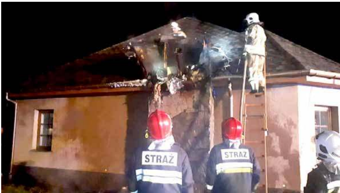
W wyniku pożaru spaleni uległ znaczny fragment stropu. Foto - OSP Sowno
