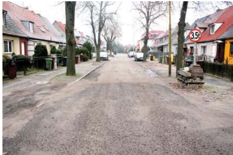
Na ulicy Polskiej nawierzchnia drogi jest w nienajlepszym stanie
