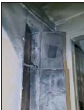
Ogień pojawił się w skrzynce elektrycznej na klatce schodowej. Fot. PSP Zamość
