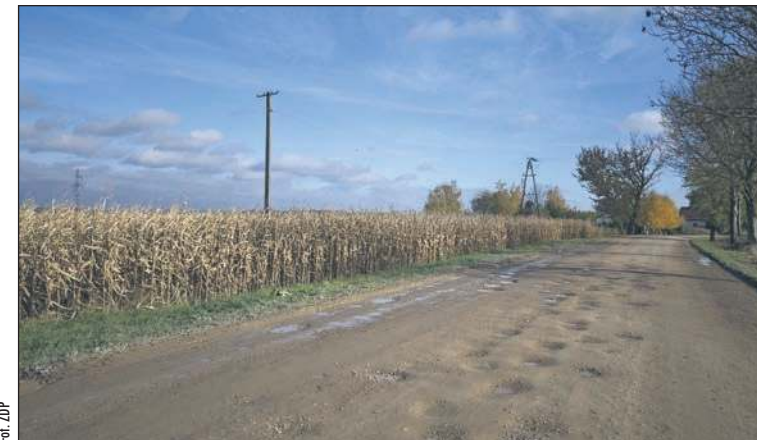
Fot. ZDP Dzisiaj droga Piączyn-Włoki to w dużej części odcinek gruntowy. Zmieni się to w ciągu 10 miesięcy
