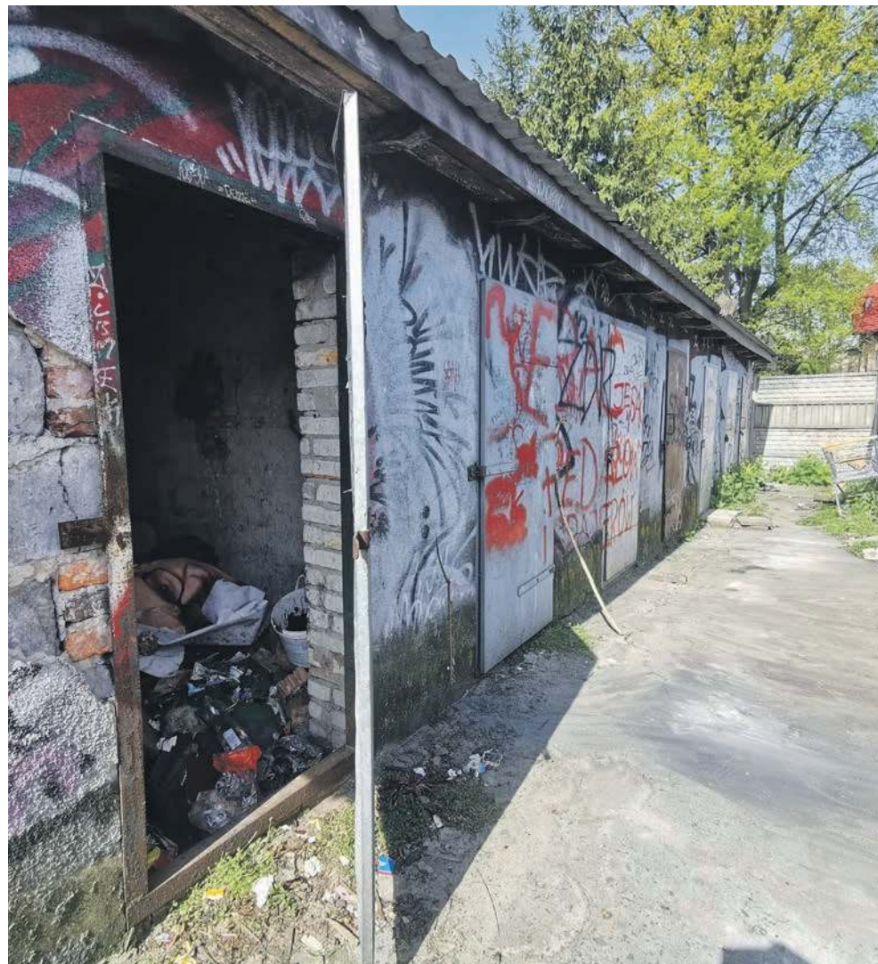
Zniszczone komórki lokatorskie
