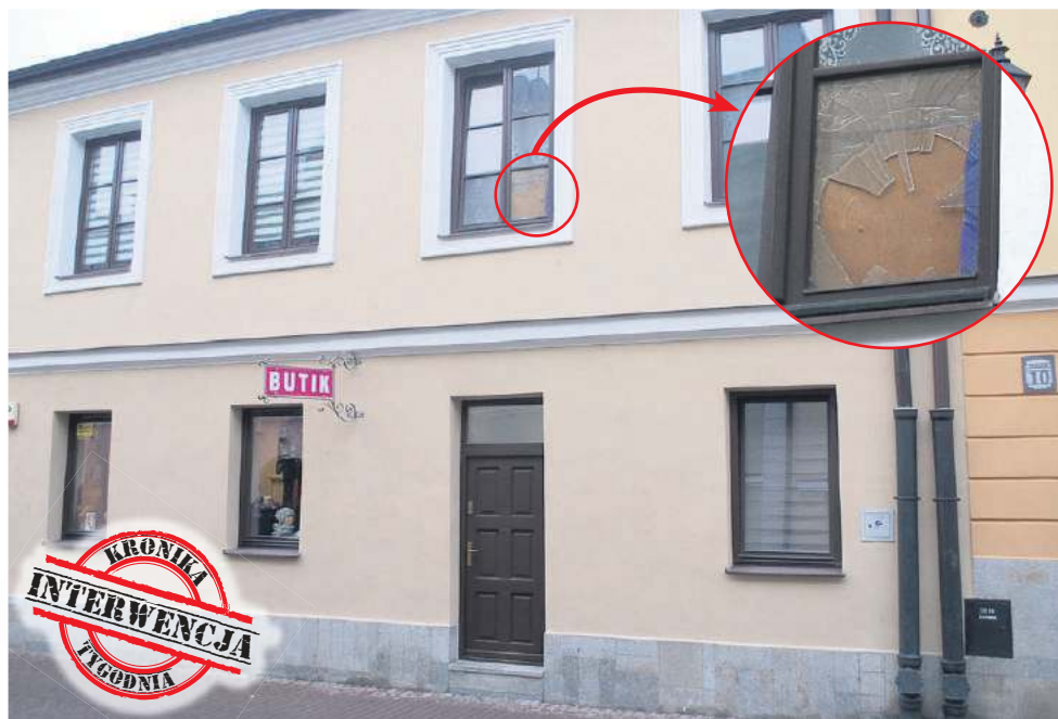
Od przeszło miesiąca nad butikiem przy ul. Pereca w ramie okna pozostają kawałki po rozbitej szybie...
