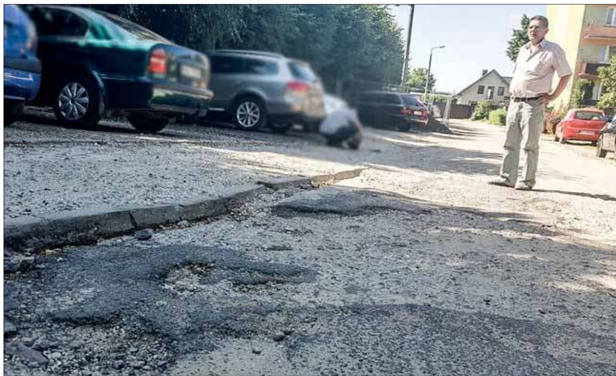
Mieszkańcy już od 2011 roku próbują skłonić urzędników do modernizacji drogi
