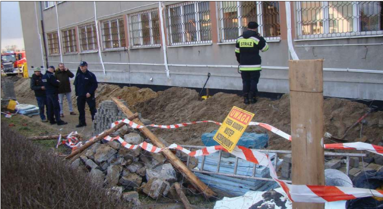
⚠ Ziemia w wykopie przy fundamentach osunęła się i zasypała dwóch pracowników
