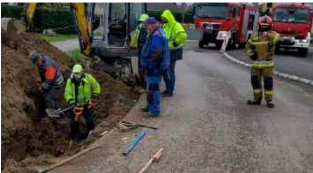
Do uszkodzenia gazociągu doszło podczas prac ziemnych
