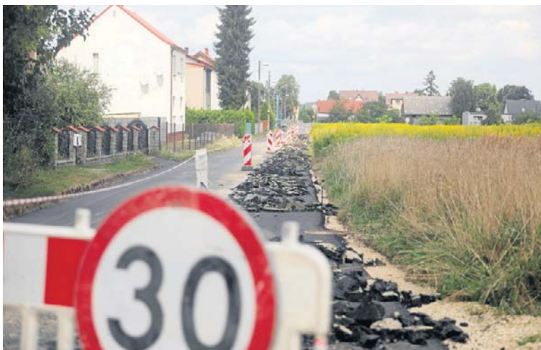
Droga przeorana przez ciągnik ma zostać naprawiona
