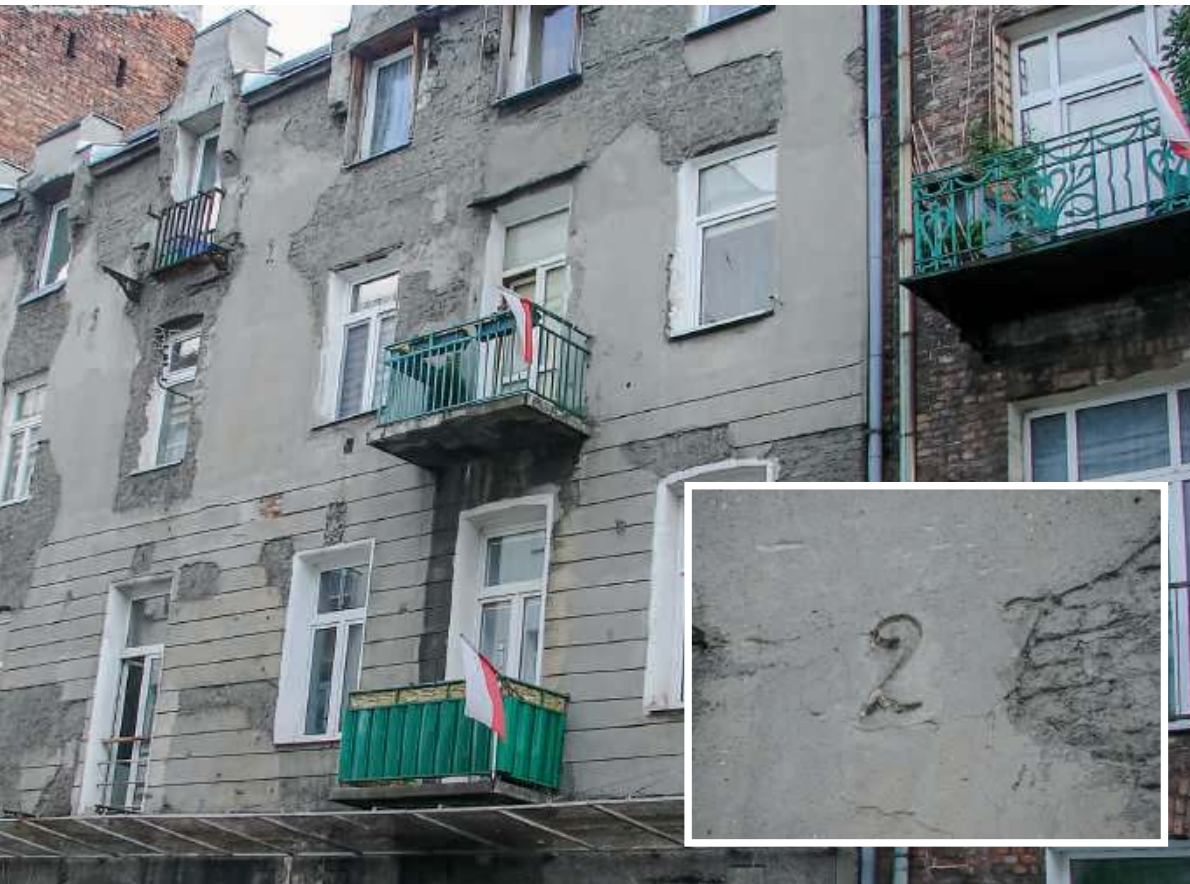
Kamienica przy ul. Kępczej 8 i ślad na jej fasadzie po jednej z cyfr daty nadbudowy | fot. Janusz Sujecki/Gazeta Polska
