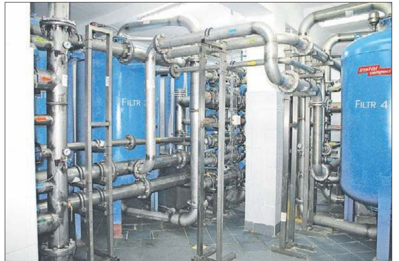
Zmodernizowana hydrofornia obsługująca sieć wodociągową w całej gminie
