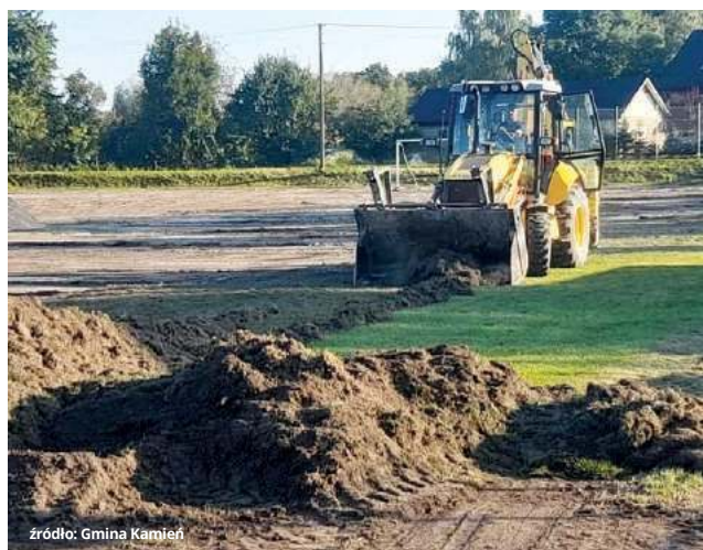
źródło: Gmina Kamień
